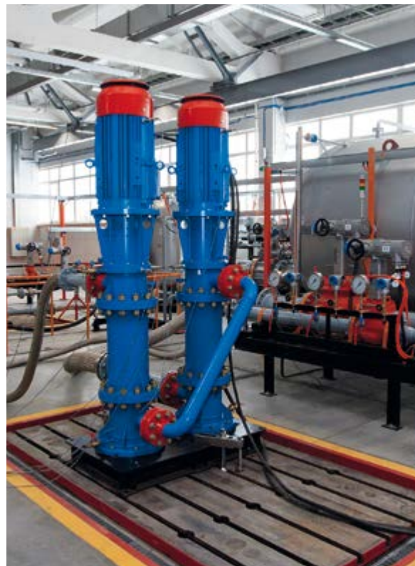
АГРЕГАТ НА СТАДИИ ИСПЫТАНИЯ
