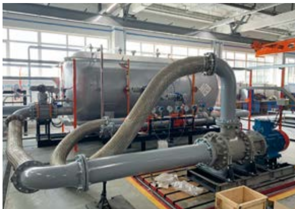
АГРЕГАТ НА СТАДИИ ИСПЫТАНИЯ
